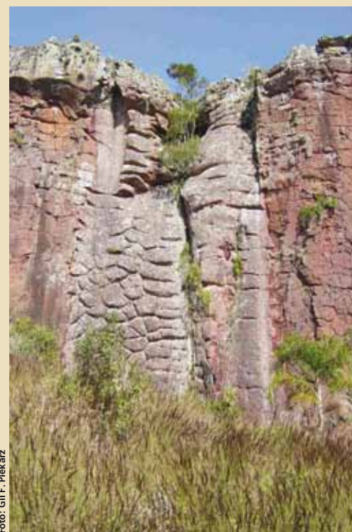
A foto 2 - os arenitos com as fraturas verticais por onde preferencialmente percola a água, com crescimento de vegetação nas fraturas;
